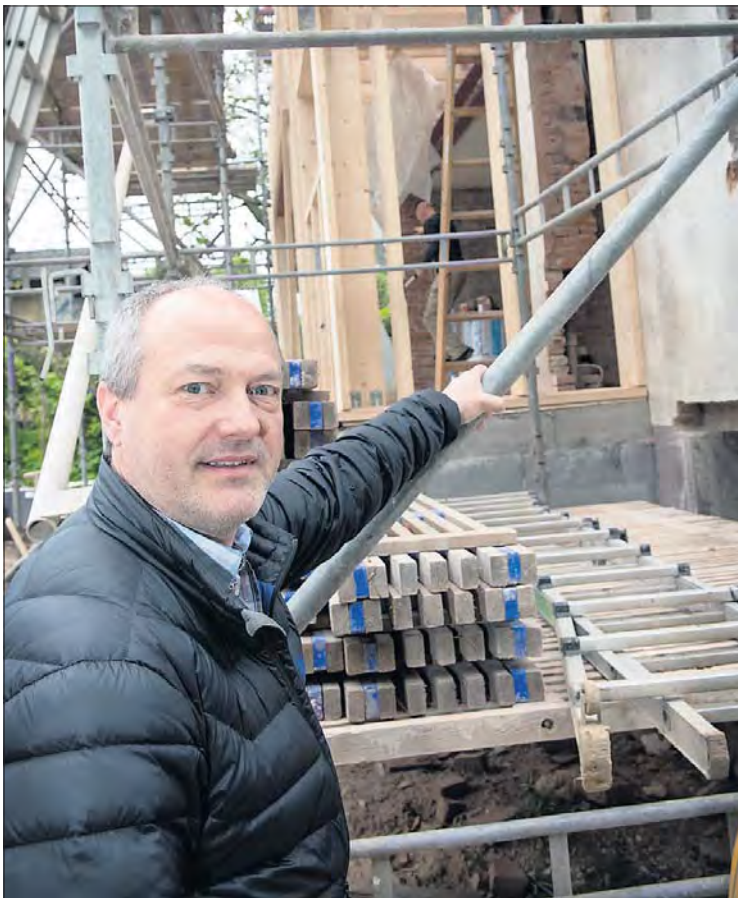
STB Håndværk er i gang med at totalrenovere en funkis-villa i Mølholm. Her fandt forretningschef Brian Bak en besparelse på en mio. kroner og bevarede samtidig alle de idéer, som bygherren havde ønsket.
